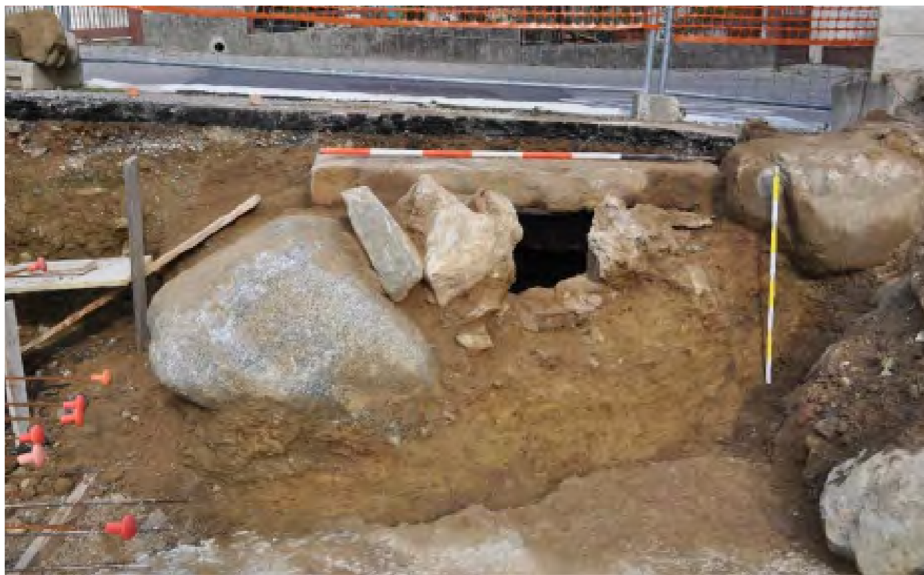
Le lastre che chiudono il pozzo erano in parte coperte dal muro dell'edificio, in parte sotto l'asfalto. Vista verso N.
